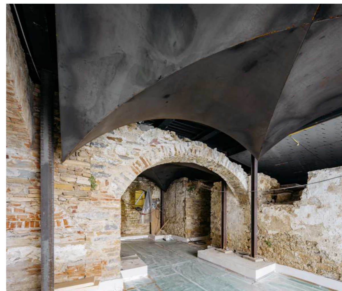
Dettaglio delle volte in lamiera di ferro naturale da 4 millimetri, lasciate a vista, che si adattano alle geometrie irregolari delle strutture in pietra
